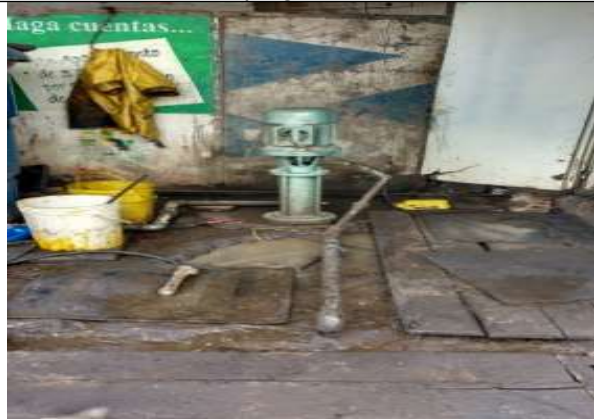
Foto No. 9. Evidencia de captación ilegal CT - 5276 de 2016
